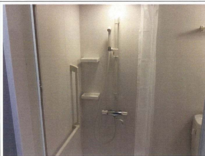
完成ユニット内部
