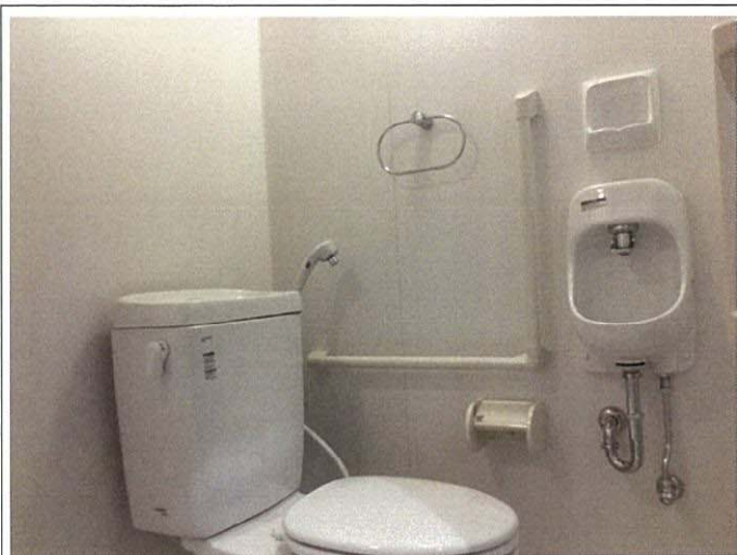
完成ユニット内部
